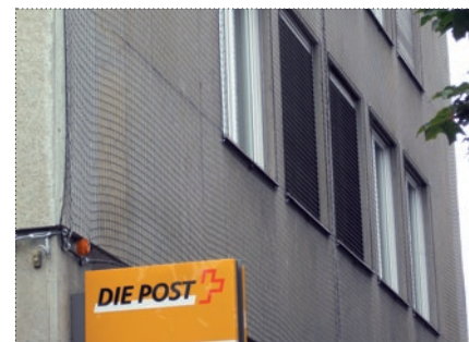
Posthaus Zürich (ZH) Fassadenschutznetze / Filets de protection pour les façades / Facade protection nets
