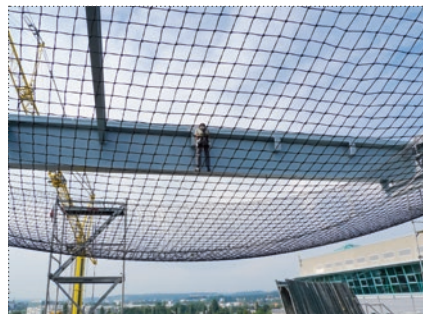
KVA Hagenholz, Zürich (ZH) Fallsicherungsnetze / Filets de retenue / Safety nets
