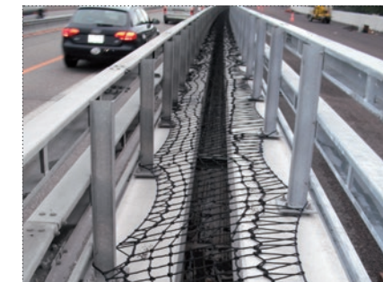
Autobahn A1 Brücken-Sicherheitsnetze / Filets de sécurité pour les ponts / Bridge safety nets
